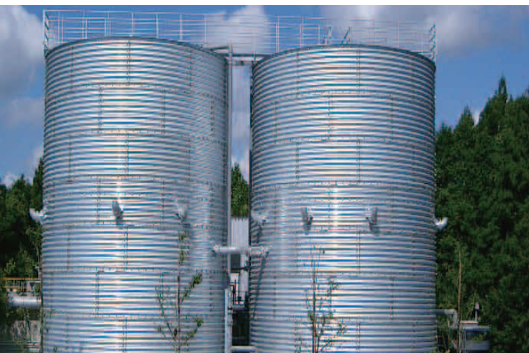
飲料廃水プラント
