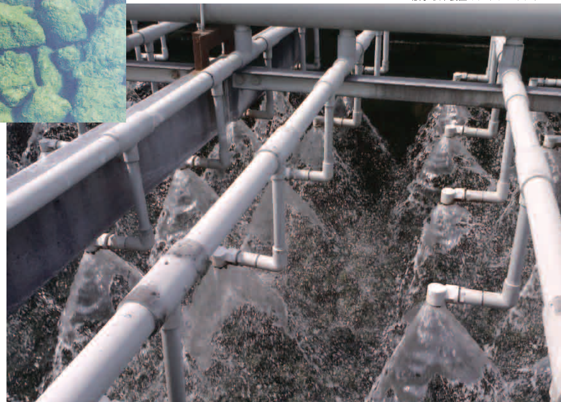
散水ろ床装置のシャワーリング
